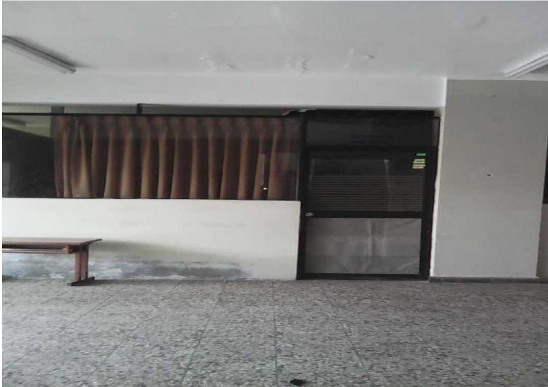
5.0.- Muros afectados por la intensidad de salitre produciéndose por la humedad de la zona afectando la estructura.
