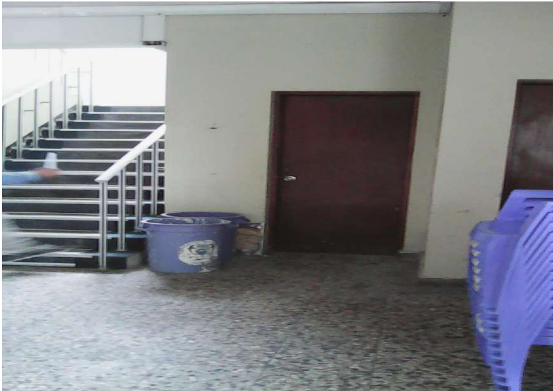
3.0.- Estructura del palacio municipal en deficiente estado para atención a la población.
