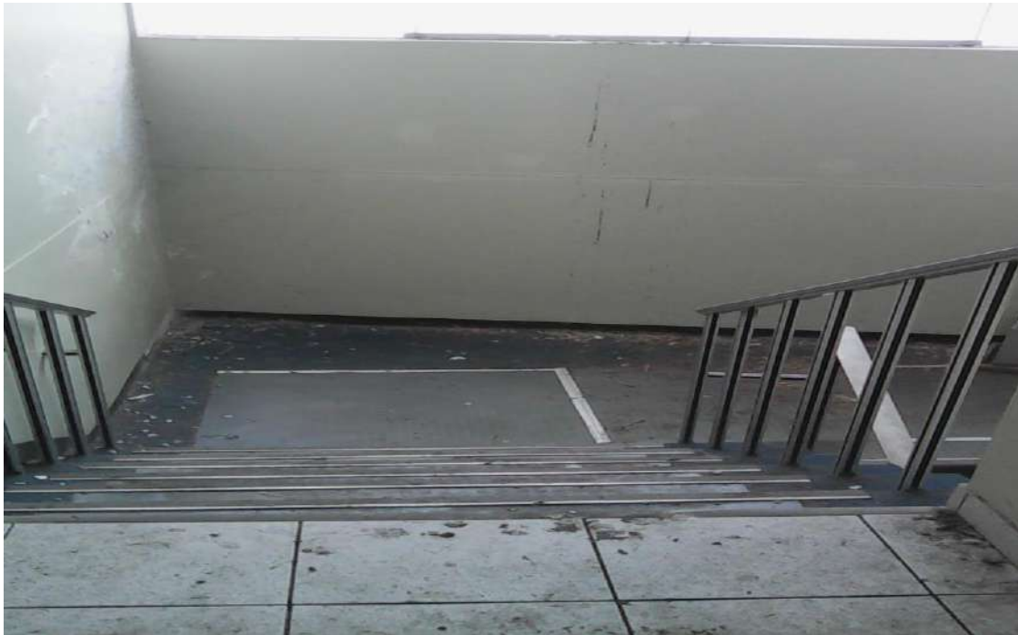
7.0.- Escaleras deterioradas, en mal estado afectados por la humedad de los suelos encontrándose debilitados e implique un riesgo en la habitabilidad
