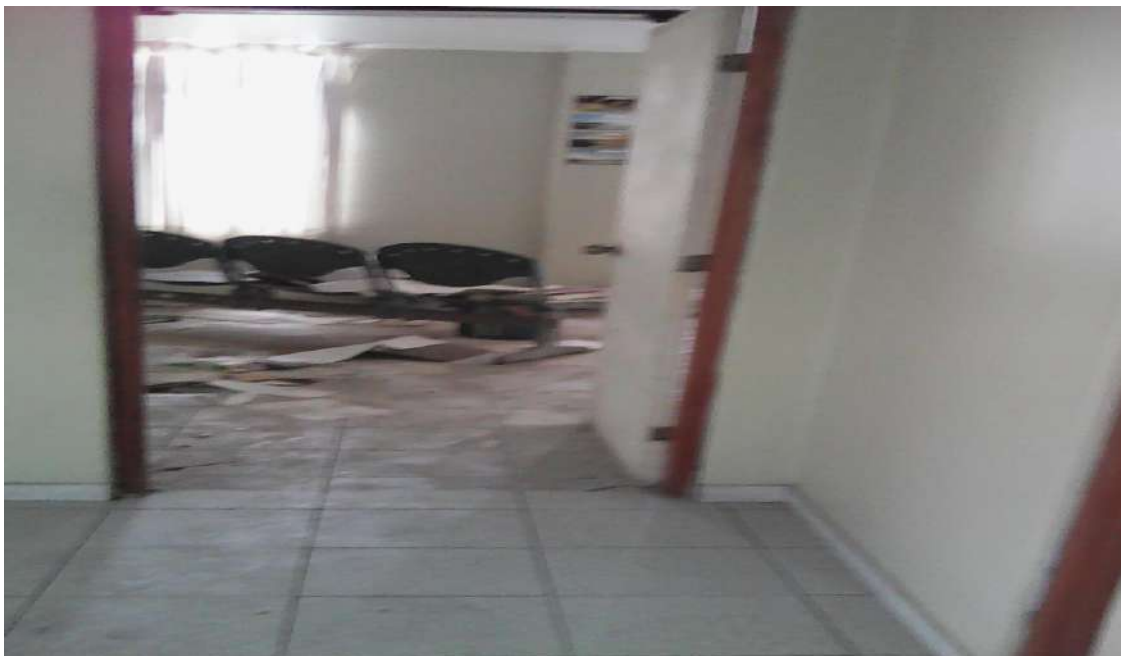
4.0.- Oficinas en mal estado por estructuras deficientes encontrándose inhabilitadas.
