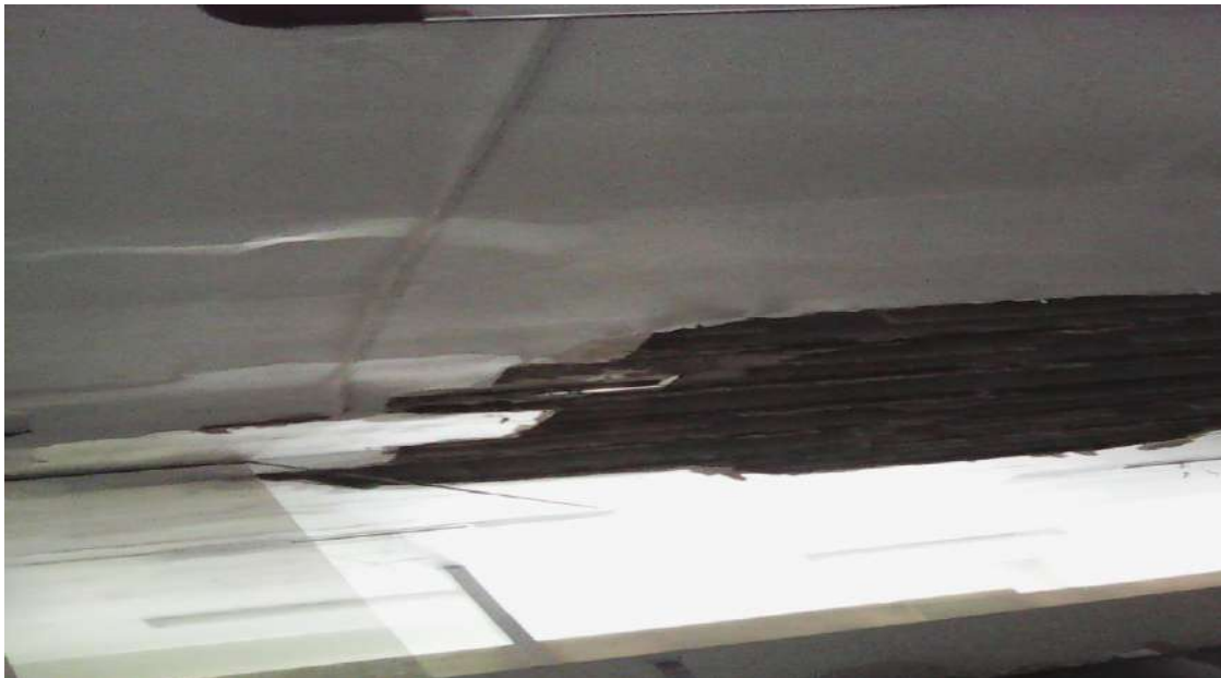
6.0.- Acero corroído con mayores componentes de sulfato. Deteriorando estructuras provocando que se encuentre debilitado y implique un riesgo a la población.
