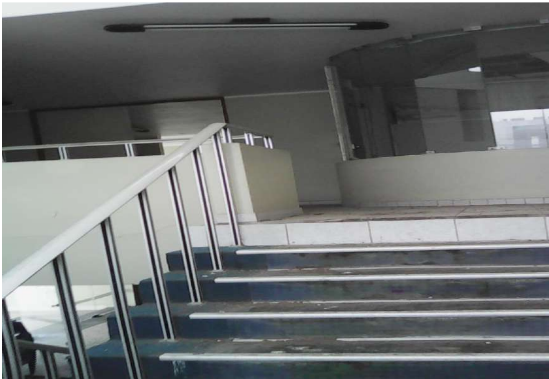
8.0.- Vista frontal de escalera donde se ve afectada por la humedad del suelo
